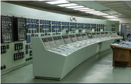
大型厂区配电房
